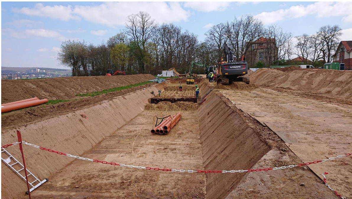
Abb. 9: Einrichtung des Erdkabeltestfeldes auf dem Reinshof der Universität Göttingen mit Beispiel einer fachgerechten Bodentrennung.
