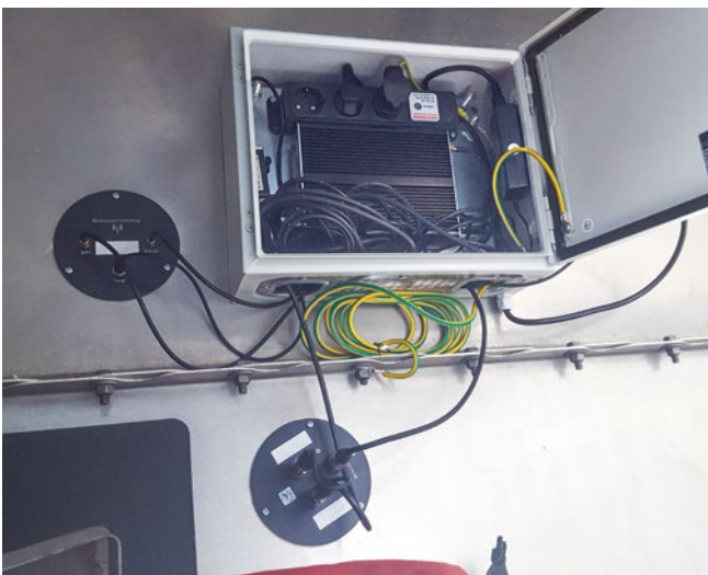
Akustische Fledermauserfassung in der Gondel: Der Aufnahme-gerät (Rekorder) ist in einem sicheren Gehäuse untergebracht. Die beide schwarzen Scheiben zeigen die Position des Mikrofons (mit Testsignalgeber und Heizung, unten) und der Antenne für die Fernzugriffsfunktion (links) an.
